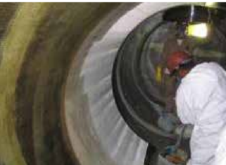
Revestimento Interno Tanques de Combustível
